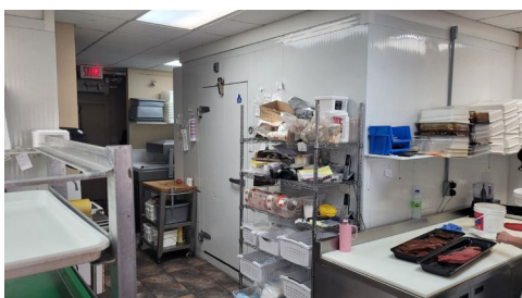
Congélateur chambre froide Norbec et évaporateur Climate Control
