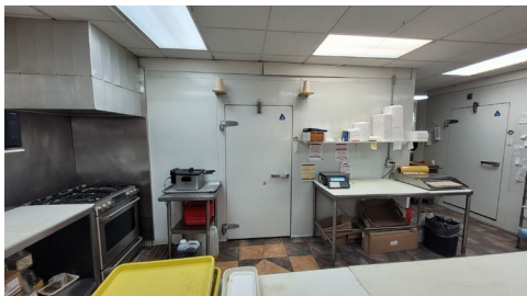
Chambre froide Norbec et évaporateur Climate Control, 208-230 volts
